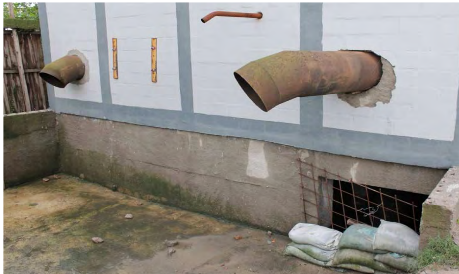
Figura 5.6: Estação de bombeamento na Av. Ipiranga
