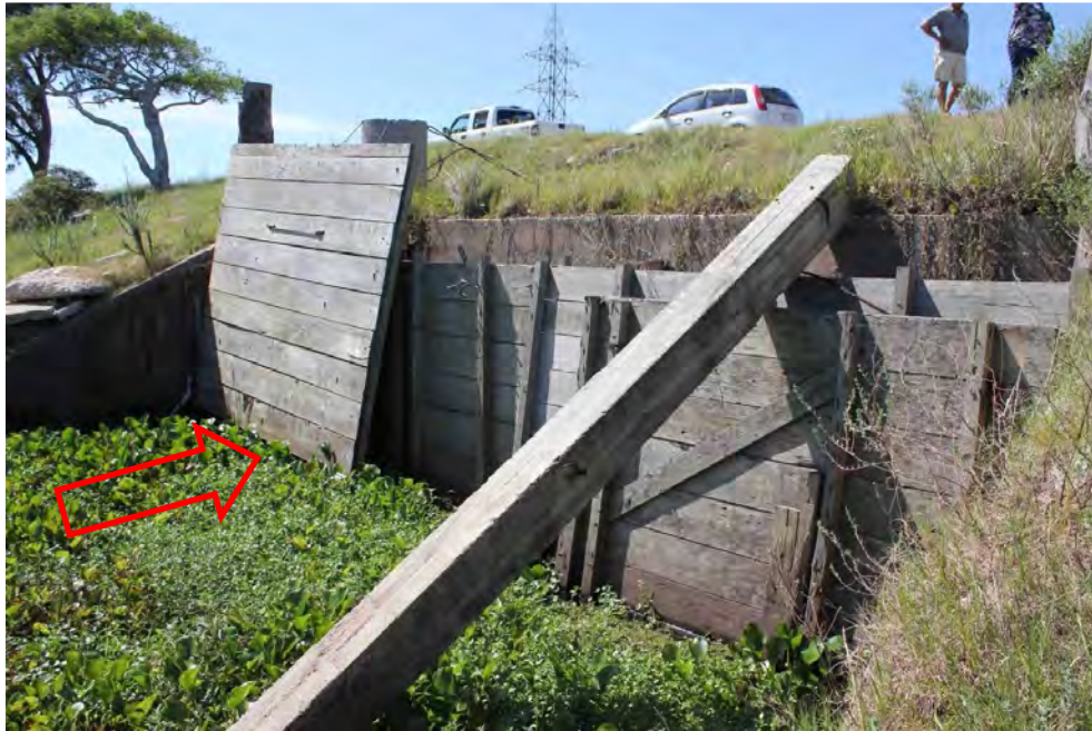
Figura 5.20: Comporta de controle de vazão do arroio das Cabeças na seção sob canal de adução
