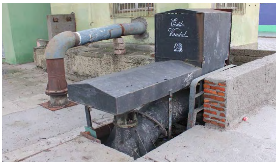
Figura 5.7: Estação de bombeamento na Rua Senador Salgado Filho
