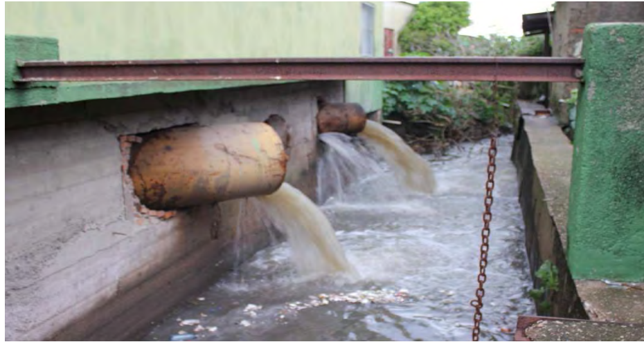
Figura 5.5: Estação de bombeamento na Rua Acácia Rio-grandense
